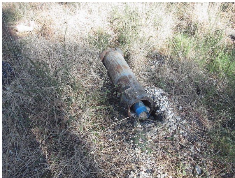
Figure 2 : Piézomètre amont (Pz5) dégradé (mars 2014)
